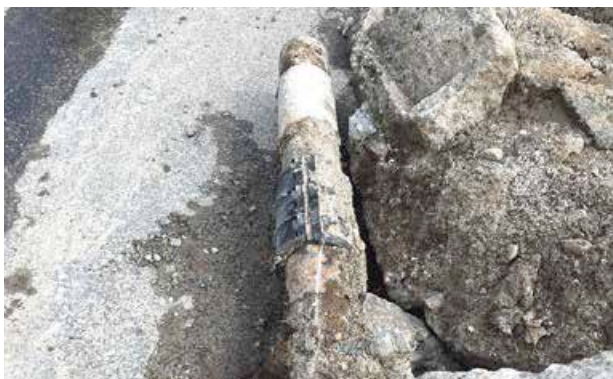
Vétuste, tout le réseau est à renouveler.
