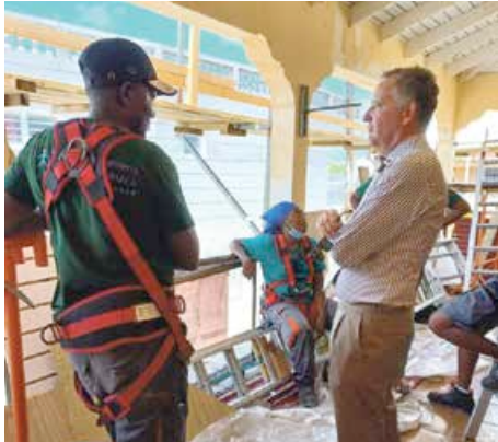
Visites de chantiers en compagnie de l'association des Compagnons Bâisseurs pour le préfet des Iles du Nord, Vincent Berton, le 18 août dernier.
