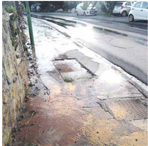
Des casses de canalisations récurrentes sur le réseau de la Baie Orientale. Ici, en décembre 2018
