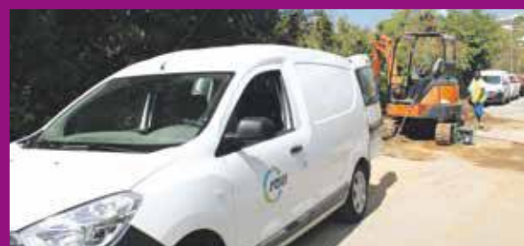
Malgré, la trêve de Pâques, les équipes de la SAUR sont à pied d'œuvre pour réparer l'importante fuite d'eau aux Terres Basses.
