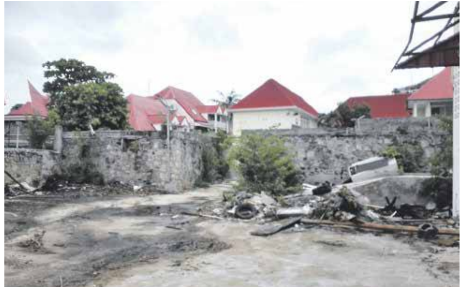
Chantier de démolition des locaux de l’ancienne gendarmerie, rue de La Liberté, à Marigot.
