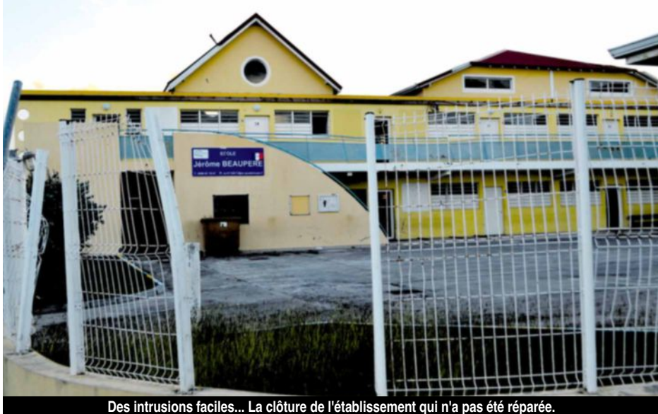
Des intrusions faciles... La clôture de l'établissement qui n'a pas été réparée.
